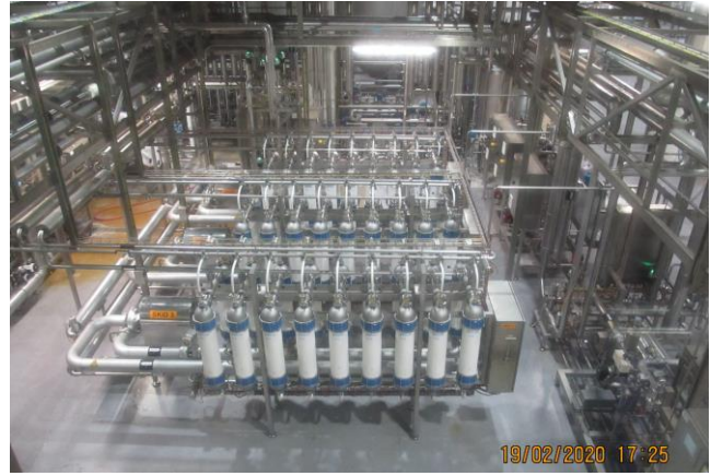
OLUEN SUODATUS LAITTEISTOA
